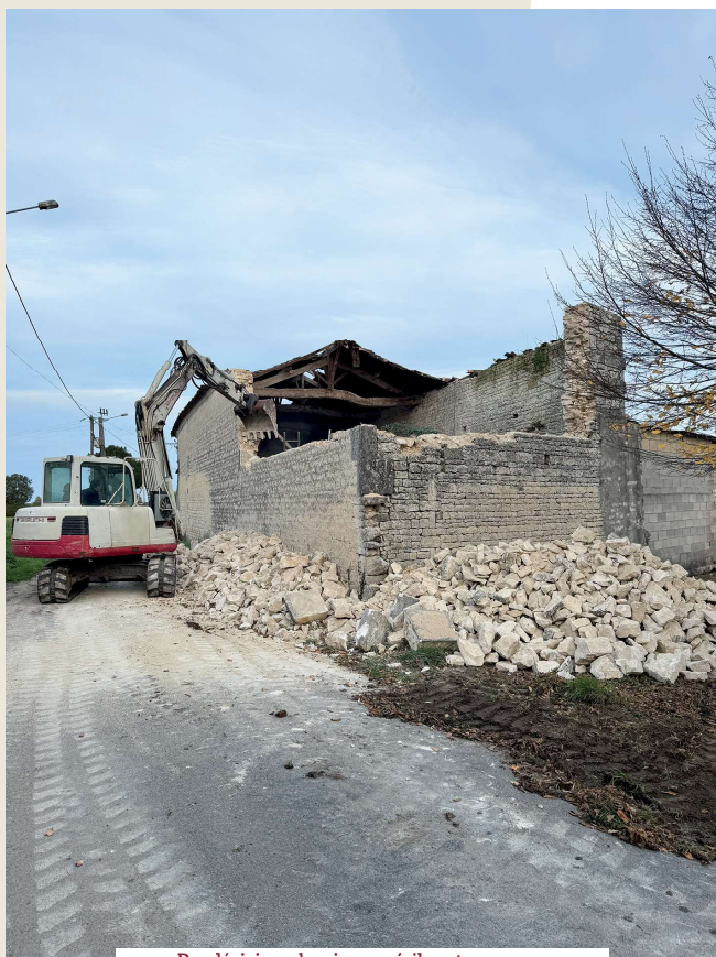
Des décisions de mise en péril sont en cours. .
